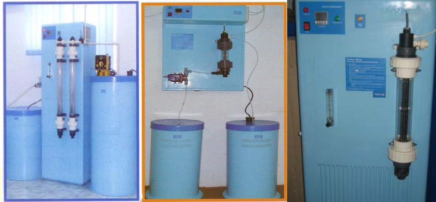
Generadores de Hipoclorito.
