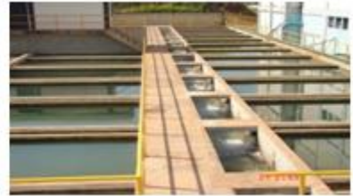
Filtros de lecho de arena.
