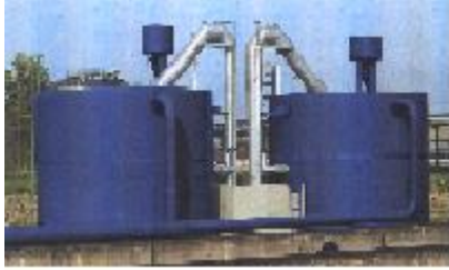
Filtros de gravedad.
